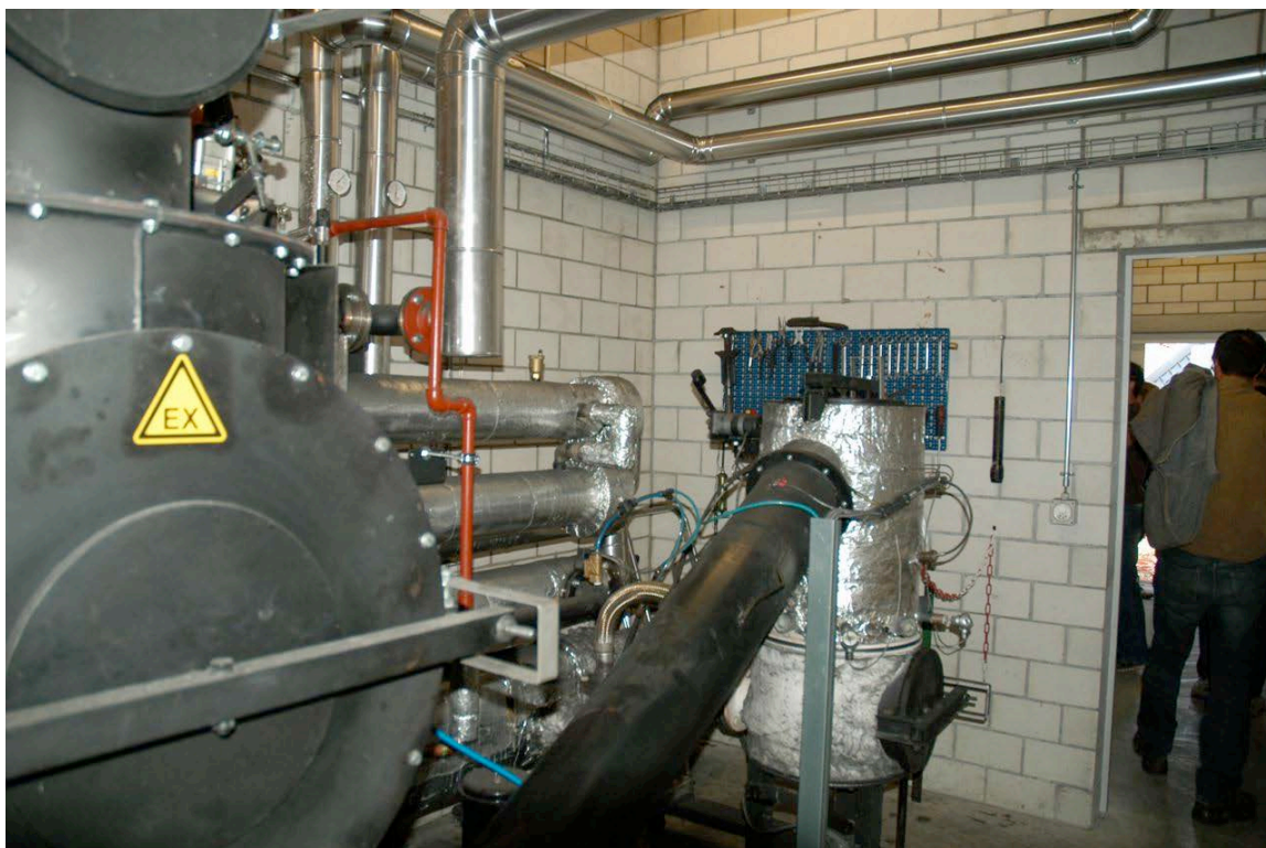
Rechts, isoliert und in Alu eingepackt, das Herzstück, der eigentliche Vergaser.
